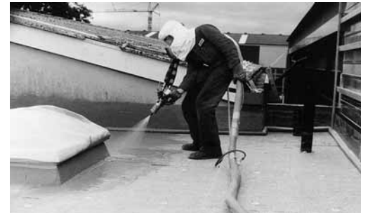
Figura 6: l'equipaggiamento di protezione che occorre per eseguire un dato lavoro deve essere prescritto e usato.
