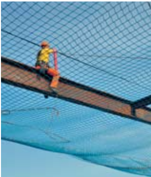
Regel 1 Kollektive Schutzmassnahmen haben Vorrang.
